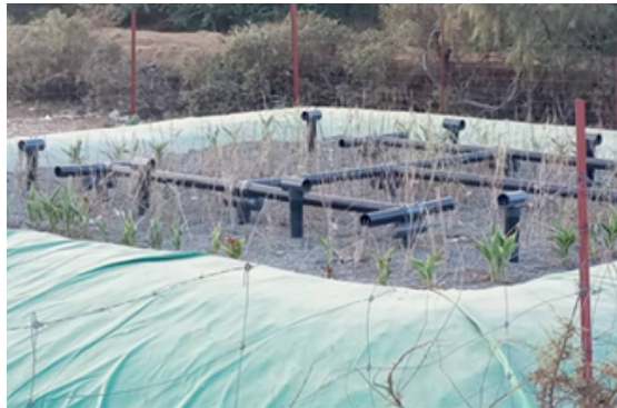
Dispositif du Filtre Planté Vert pour améliorer la qualité du traitement des eaux de la STBV à Rosso au Sénégal
