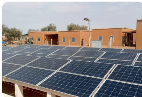
Projet PAER (Programme d'Accès aux Energies Renouvelables)
