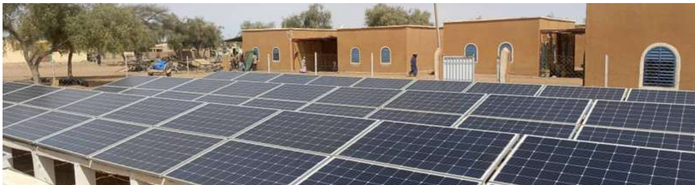
Plateforme énergétique solaire de Mbidi
