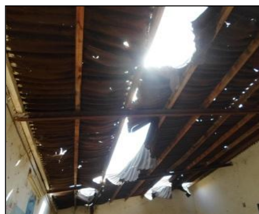
Toiture avant réparation
