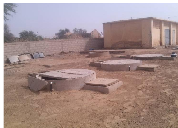
Unités biogaz des abattoirs de Podor
