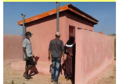
Les 8 cabines de latrines du Marché Radar – 24/11/20
