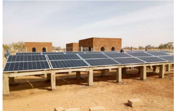
La plateforme énergétique construite à Mbiddi
